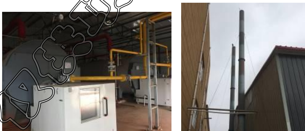
图 3-2 锅炉排气筒现场照片
