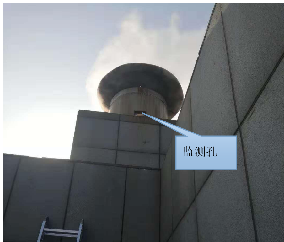
图 4.2-4 锅炉废气监测孔
