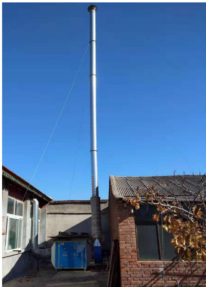
图 3-1 项目光氧催化净化器及 15m 高排气筒
