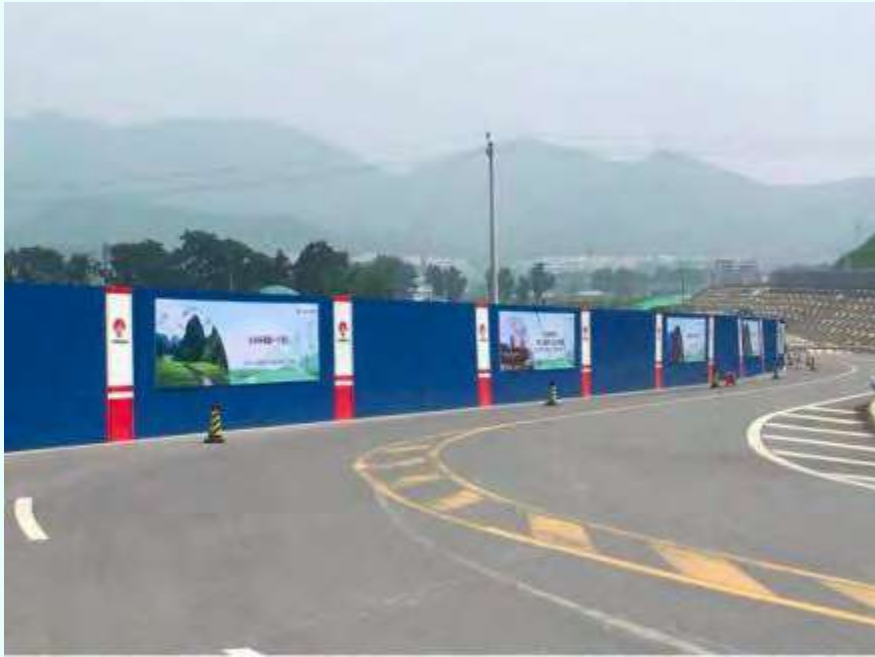
图 6.2-1 施工期场地围挡图
