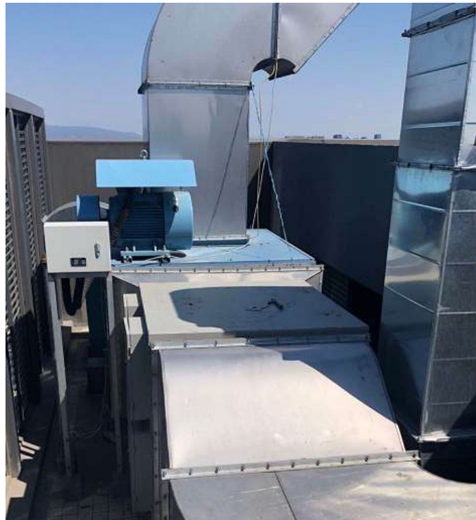
图 4-4 废气处理设施
