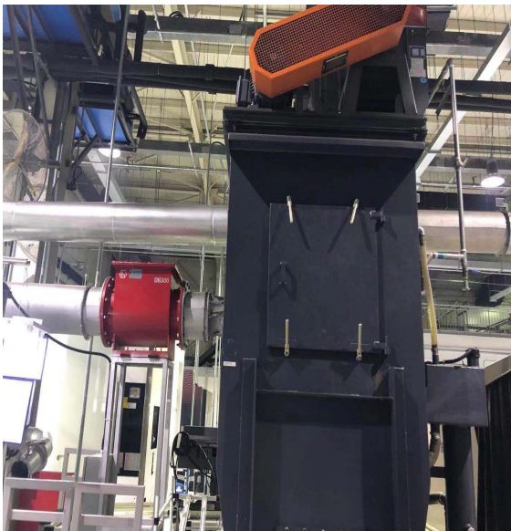
图 4-3 废气治理设施
