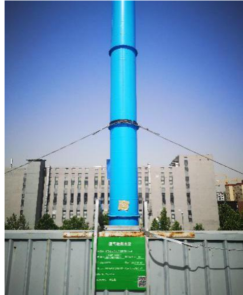
图 4-4 废气排口标志牌
