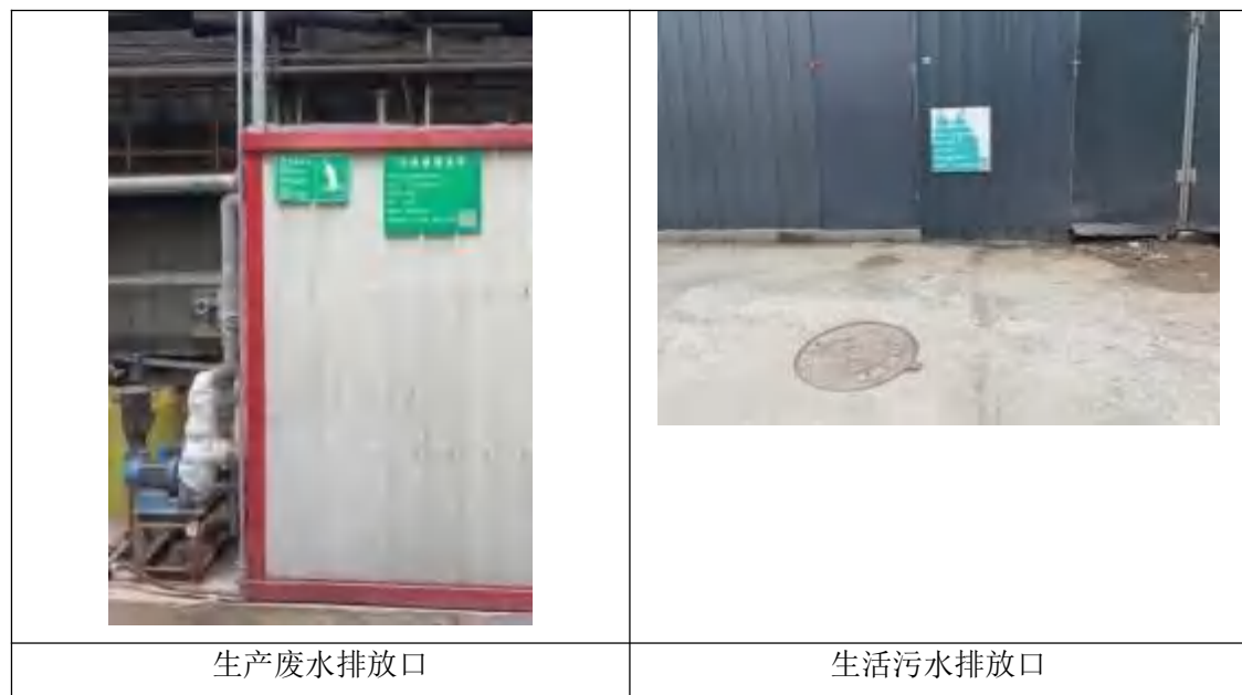
图 4-4 废水排放口标识牌
